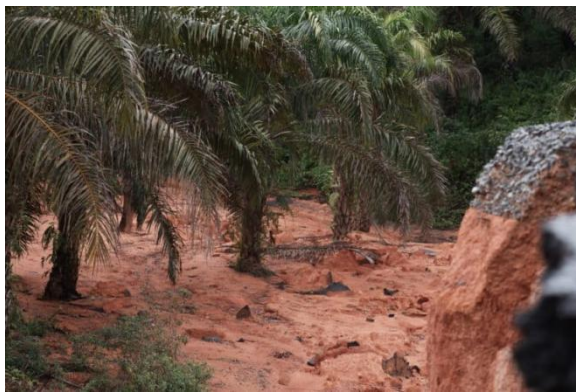
gambar 31. kerusakan lereng akibat tanah longsor
