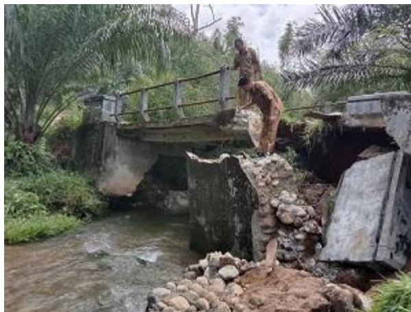
gambar 33. kerusakan jembatan akibat banjir
