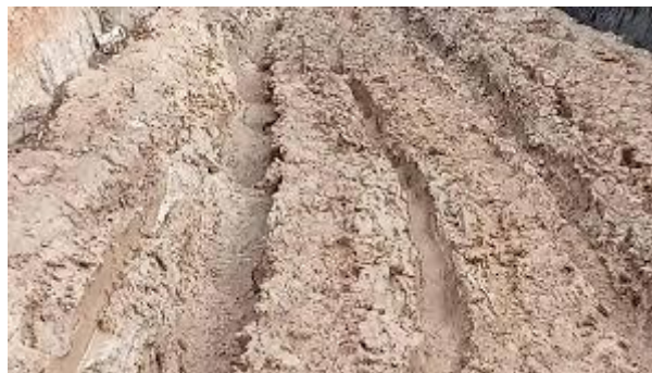
gambar 32. kerusakan akses jalan akibat banjir
