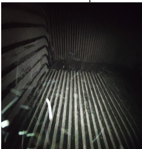
Bagian dalam boiler
