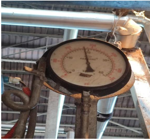
Indikator suhu dan tekanan boiler
