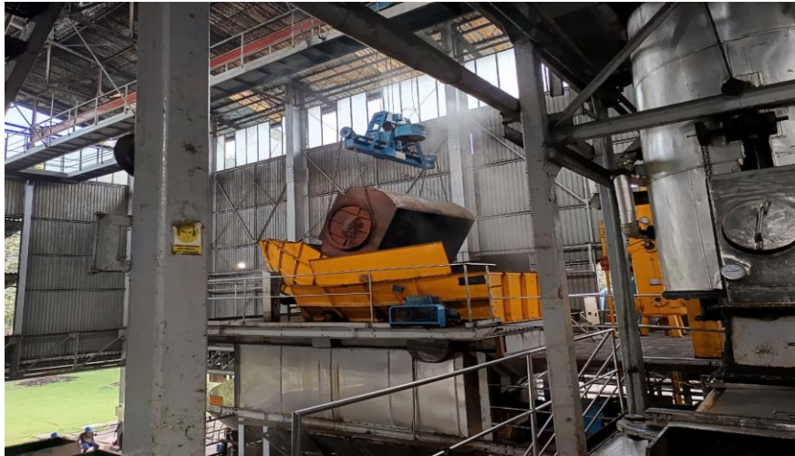
Gambar 58. Proses Penuangan TBS yang Sudah di Rebus ke Stripper
