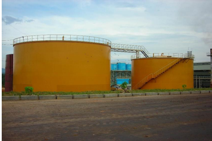
Gambar 61. Penyimpanan minyak sementara (storage tank)
