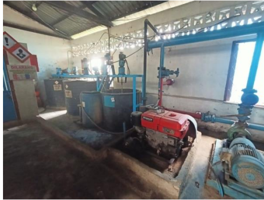
Gambar 3. 71 Rumah Pompa WTP
