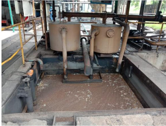
Gambar 3. 39 Final Effluent Pit
