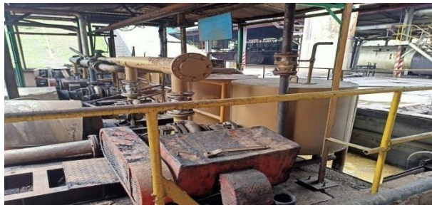
Gambar 3. 84 Pompa Final Effluent Pit
