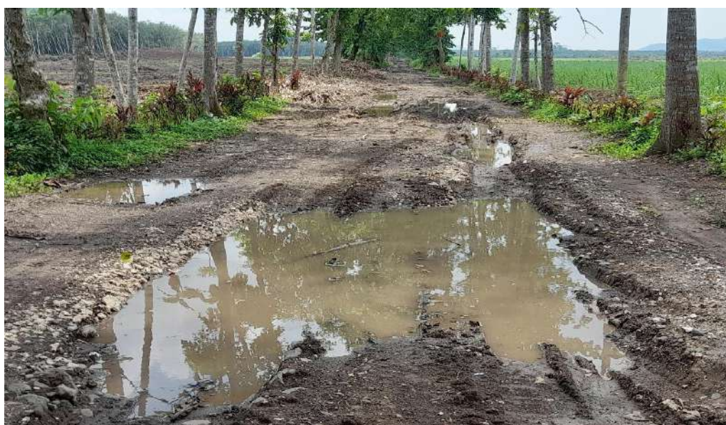
Gambar 38. Kondisi Jalan Kebun (jalan non program PMN) Yang Rusak Di Kebun Renteng
